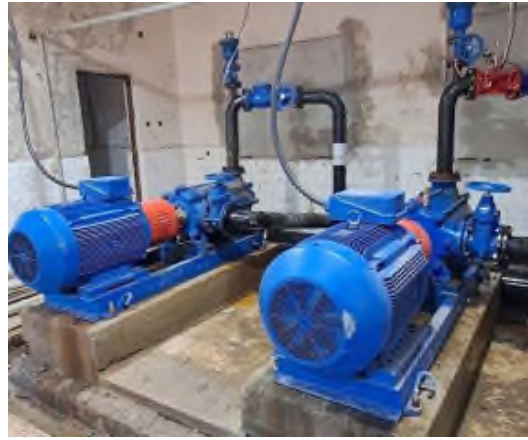
İçme suyu pompaları
