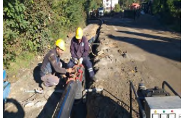
ÇAYDAMAR MAHALLESİ ÖZEL İDARE MEVKİ ŞEBEKE HATTI
